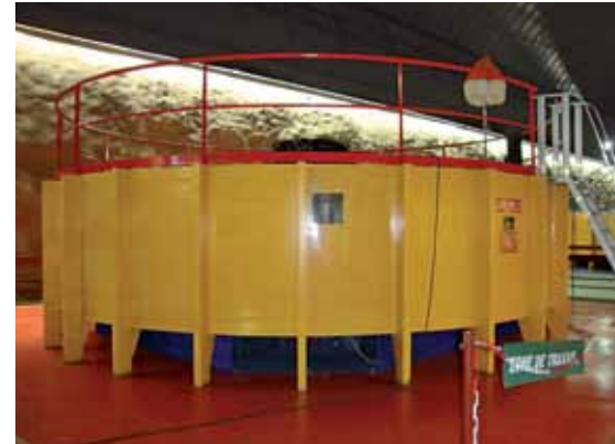
▲ Unité 2 de la centrale hydroélectrique (moteur de démarrage en mode pompe)
