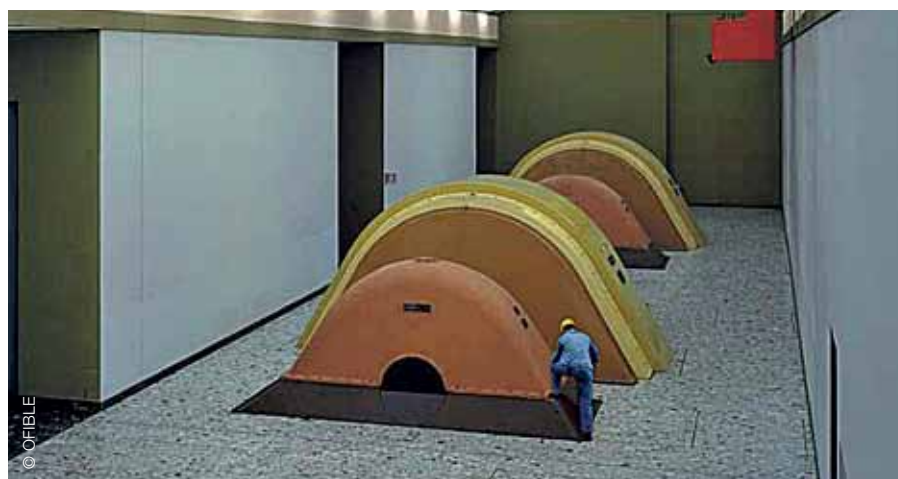
▲ La salle des machines
