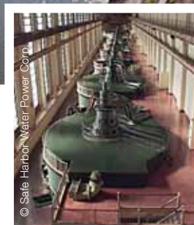
▲ La salle des machines
