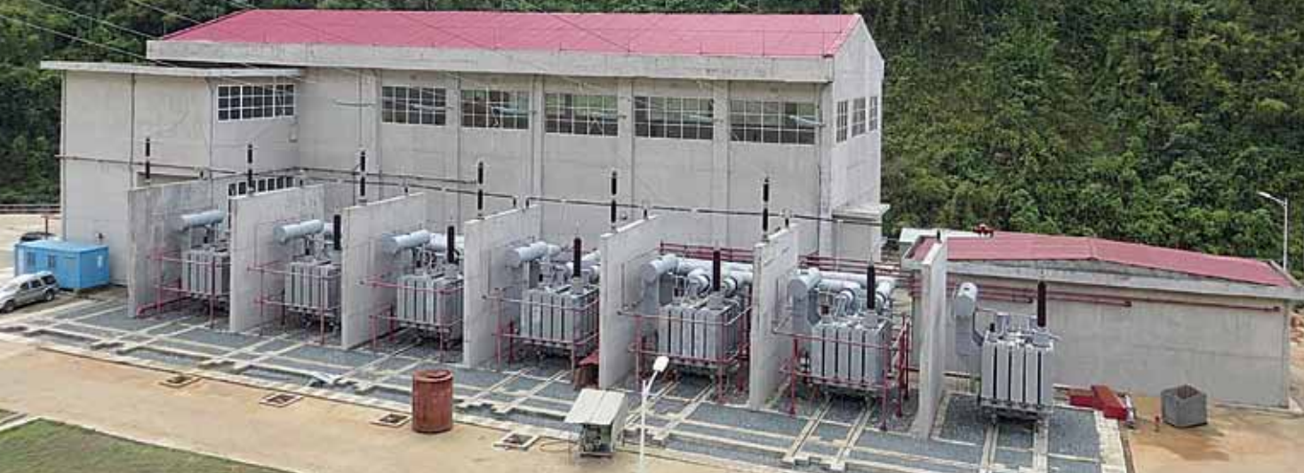
▲ La centrale hydroélectrique de Xekaman 3
