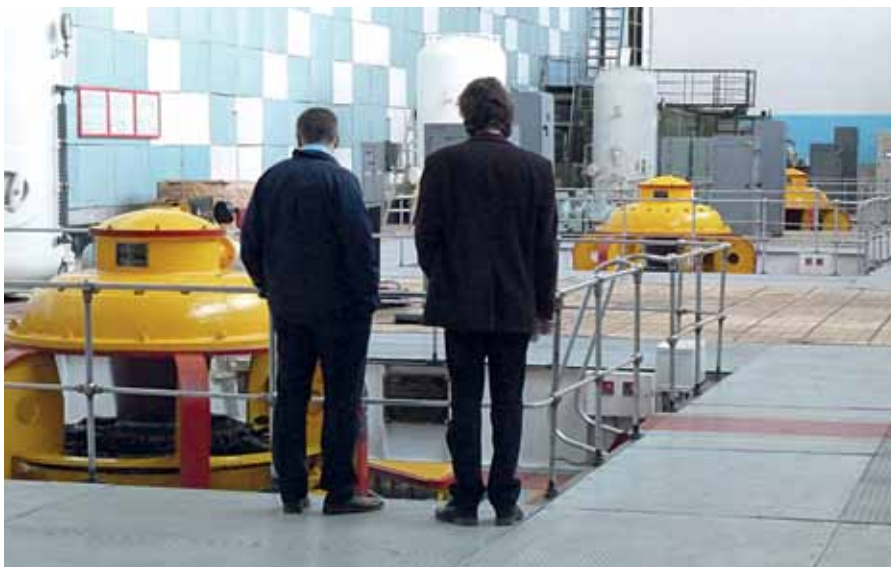
▼ La salle des machines
